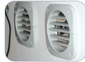
Abbildung: Luftanschlüsse an der Außenfassade.
